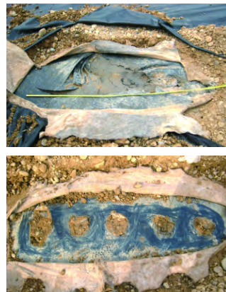
图 3 上海某垃圾填埋场机械破损孔洞
