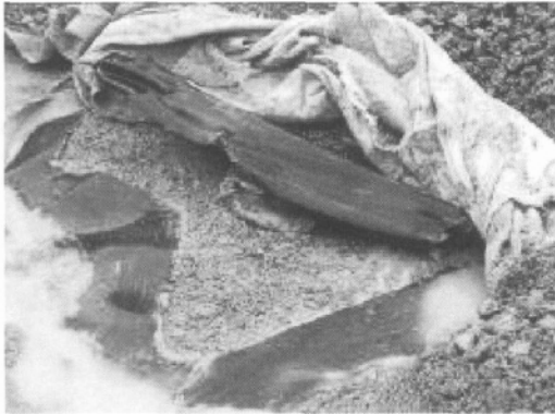
图5 较大机械破损孔洞
